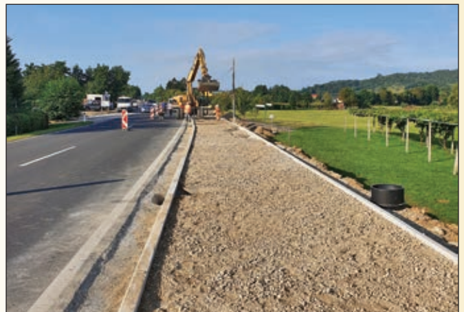
Izgradnja mešane površine za pešce in kolesarje na odseku semaforizirano križišče Fram-Radizel
